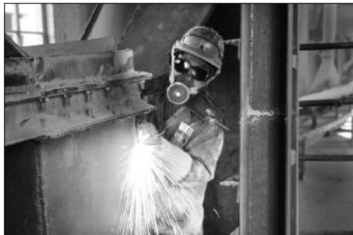
近日,检修分厂检修车间在氧化铝石灰斗提技改工程中,严格要求施工精度和质量,施工人员在30多米高的斗提筒中,冒着呛人的石灰粉尘,对轨道以及支架逐节检测、校正,目前已进入斗链回装阶段。图为检修人员在精心修理下料口部分。摄影报道 杨路平 张安泽
