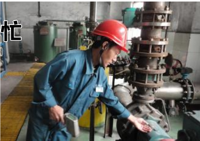
图为化学车间运行人员巡检现场设备。摄影 吕建杰
